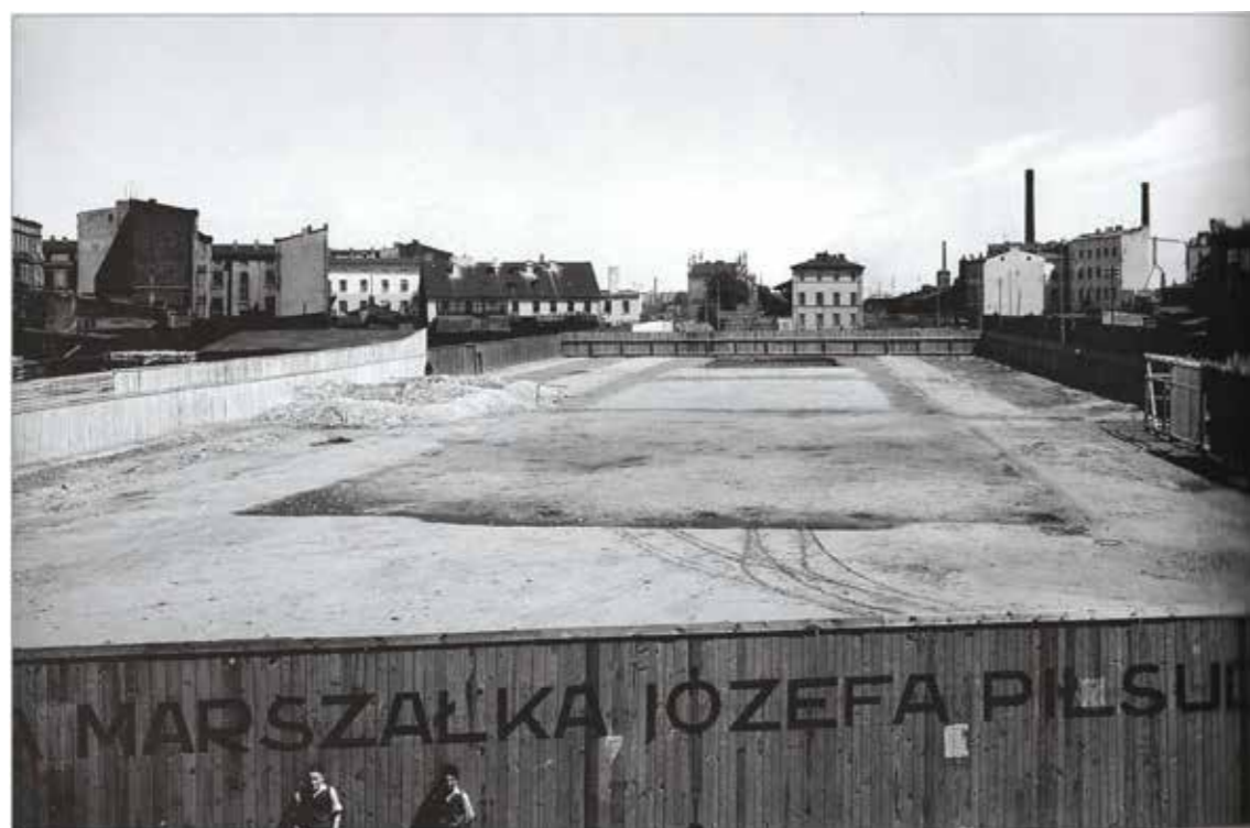
Oczyszczony i ogrodzony plac budowy Domu Pomnika Marszałka Józefa Piłsudskiego, 1933, autor Włodzimierz Pfeiffer, źródło: Sentymentalna podróż po Łodzi, opr. zbiorowe, Łódź 2009
